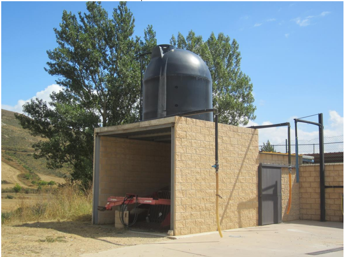
Instalación de llenado de agua
